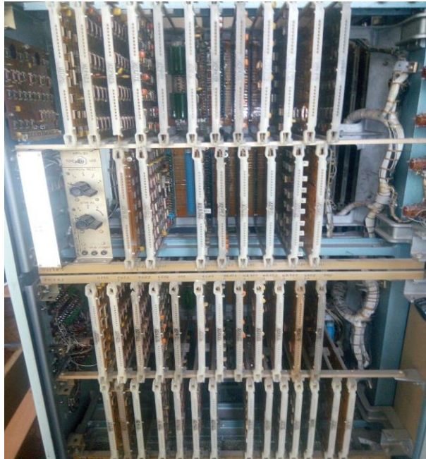
Фото 3.1. Шафа 195ПВ01 РЛС 19Ж6 зі знятою панеллю
