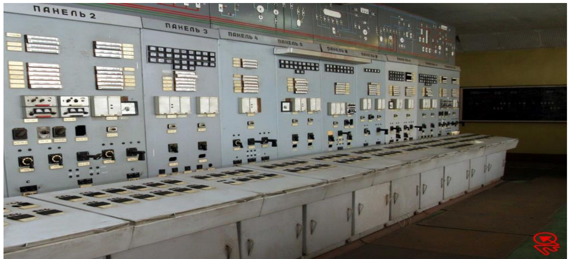
Фото 1.5. Обладнання атомної електричної станції
