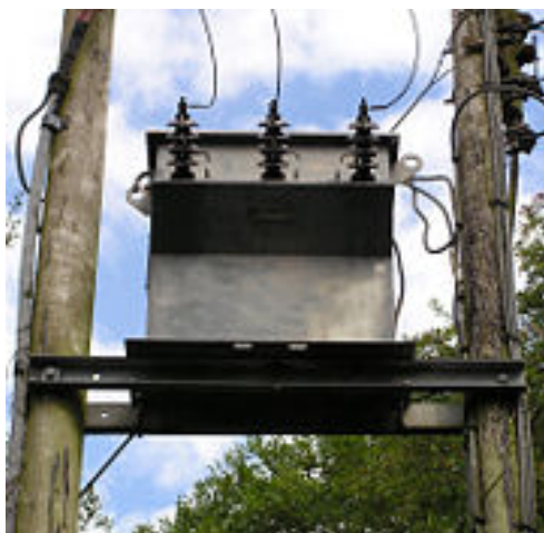
Рисунок 8.10 – Трифазний трансформатор лінії електропередачі
