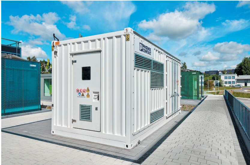
Рис. 2. Встановлений у парку All Electric Society контейнер для акумуляторів з енергосмістю 1.25 МВт·год створює необхідну гнучкість електромережі. Шафи керування в контейнері оснащені компонентами Phoenix Contact
