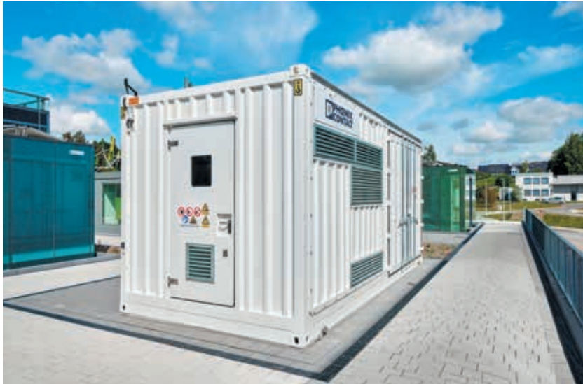
Рис. 2. Встановлений у парку All Electric Society контейнер для акумуляторів з енергоємністю 1.25 МВт·год створює необхідну гнучкість електромережі. Шафи керування в контейнері оснащені компонентами Phoenix Contact
