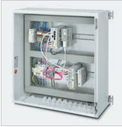
Рис. 6. Стандартизована апаратна структура сертифікованого контролера входу електростанції від Phoenix Contact
