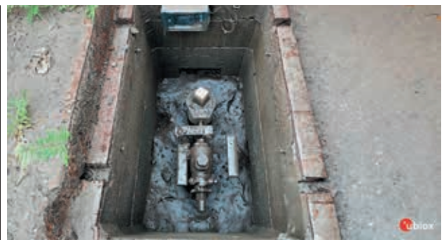
Рис. 2. SULPI розміщується всередині люка, під землею, оточений товстим бетоном і металом
