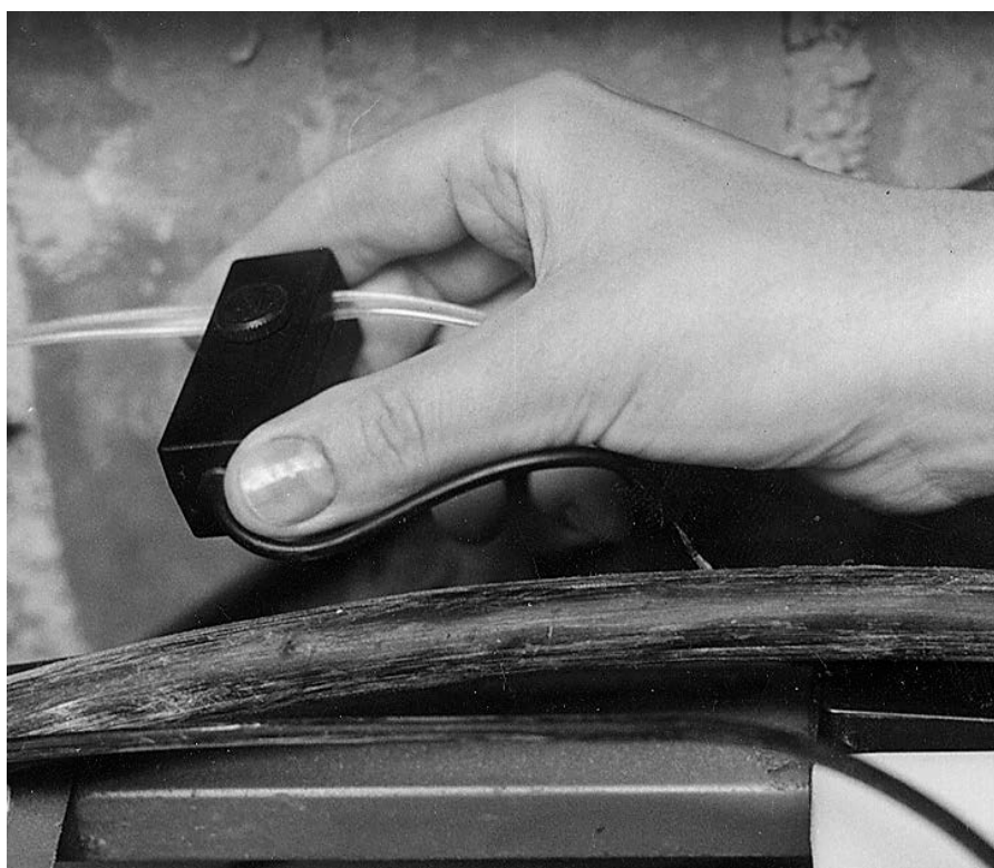
Рис. 103. Подключение к телефонной линии в зоне «Б»
