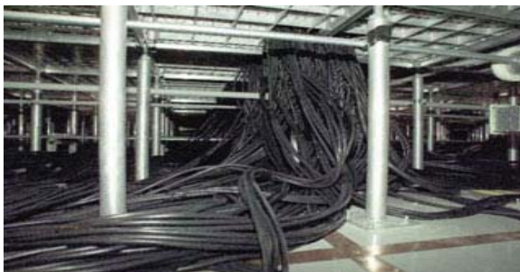
Кабельное соединение узлов суперкомпьютера ASCI White
