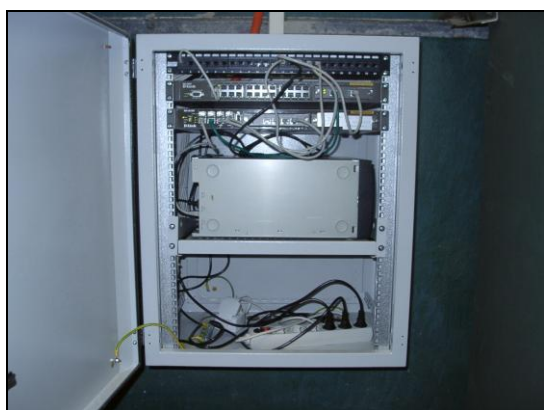
Рис. П4.3. Шкаф с сетевым оборудованием
