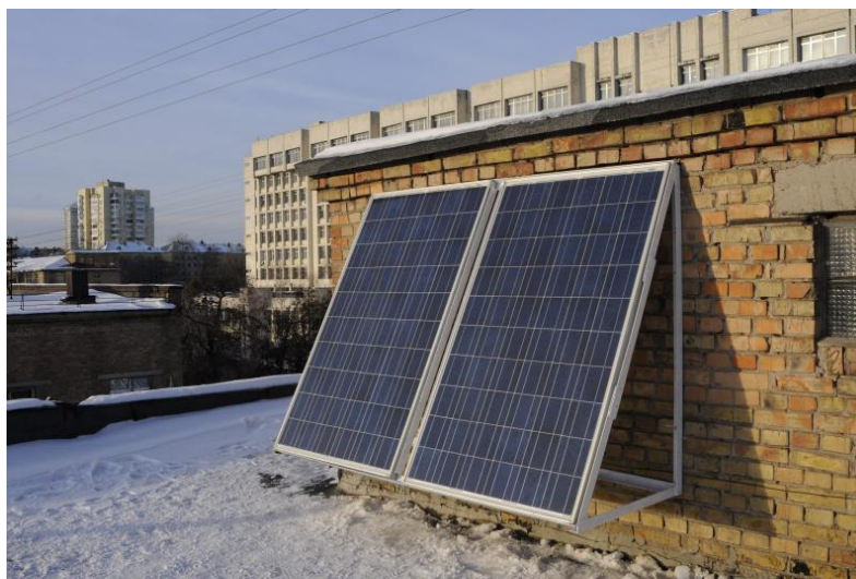
Рисунок 6.1 – Сонячні панелі на даху корпусу №17
