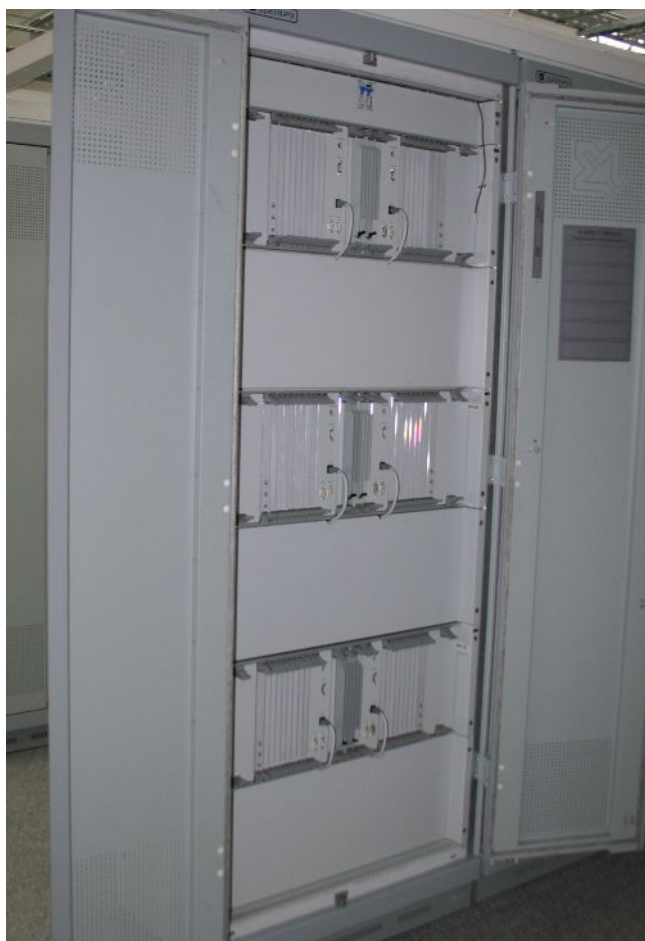
Рисунок 3.2 – Блоки БОС в шкафу
