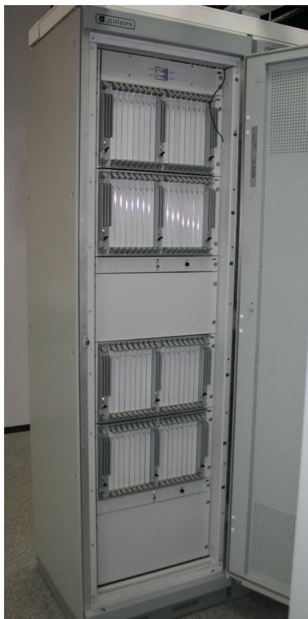
Рисунок 3.42 – Блоки БА064 в шкафу
