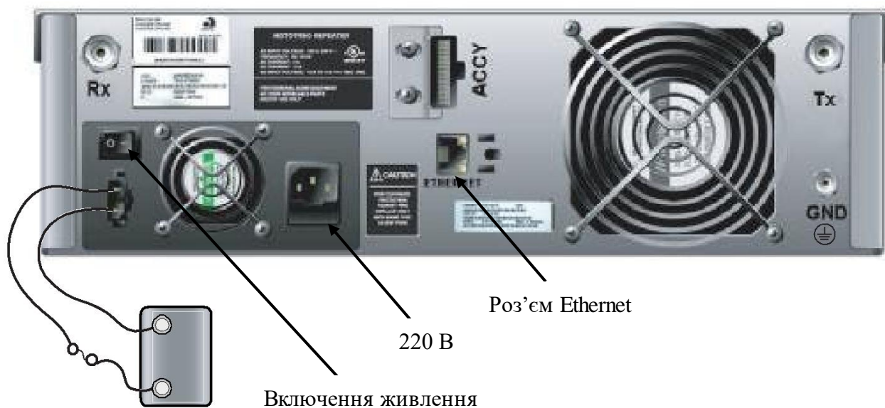
Рис. 2.18 Зовнішній вигляд задньої панелі ретранслятора DR3000 з підключеним резервним акумулятором
