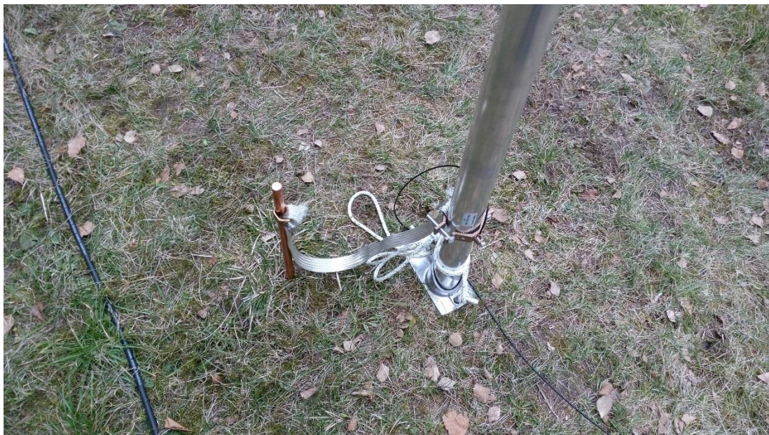
Рис. 5.35 Обладнання заземлення щогли антени КХ
