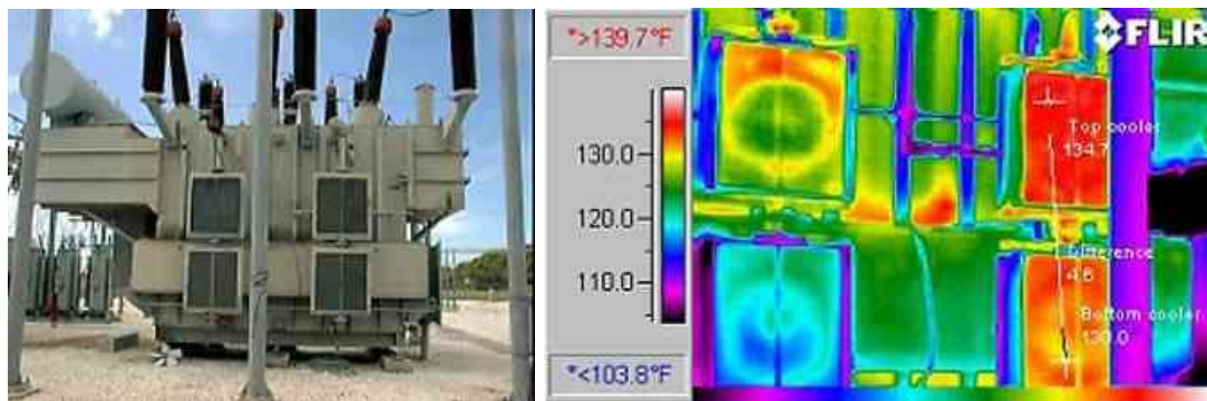
Рис. 1.7. Термограма силового трансформатора(бак і радіатори)
