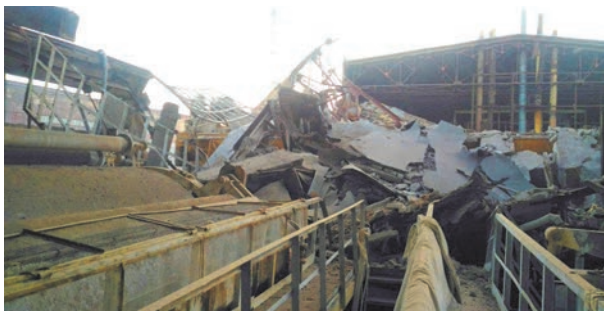
Обвал конструкцій покрівлі площею близько 3,5 тис. м 2 в одному з цехів підприємства «Кримський Титан» (виробник діоксиду титану) у серпні 2017 р.
