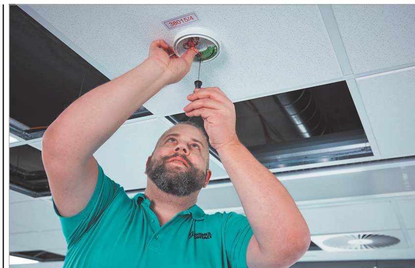
Рис. 1. Під час розробки систем пожежної сигналізації, окрім надійності з'єднання, проєктувальники повинні врахувати інтуїтивно зрозуміле та швидке з'єднання проводів, що заощаджує час
