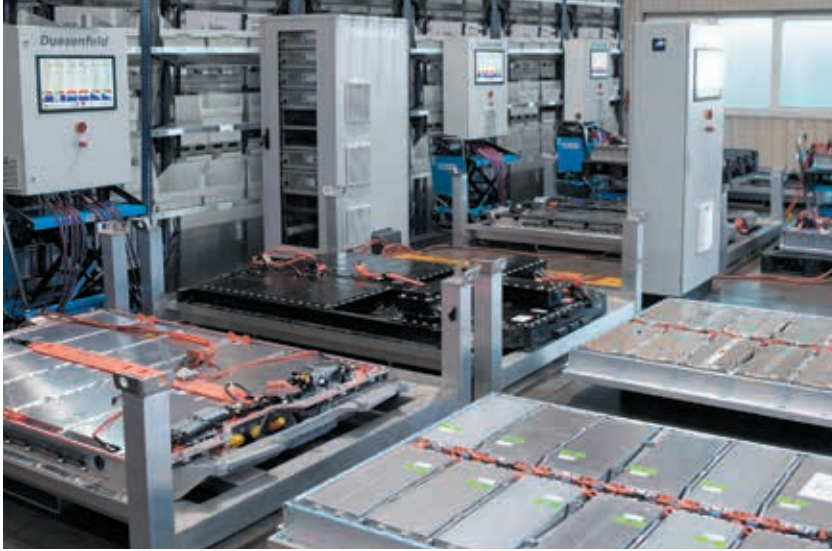
Рис. 3. Акумуляторні батареї електромобілів розряджаються перед демонтажем. На передньому плані можна побачити окремі повністю зварені акумуляторні модулі
