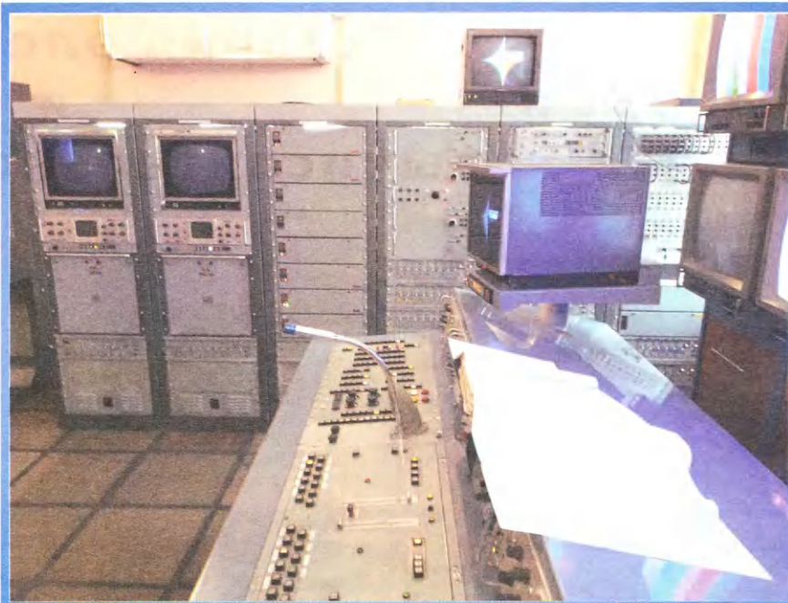
Стойки телевизионного оборудования.
